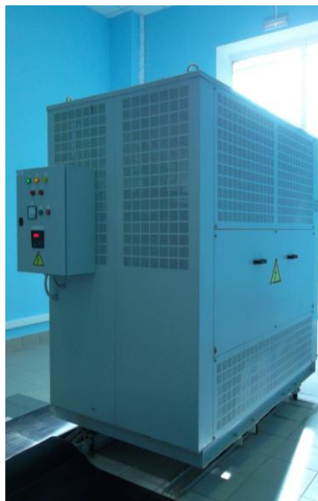
Рис. 9. Сухой силовой трансформатор
