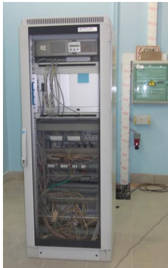
Рис. 7. Шкаф контроллера МСУ
