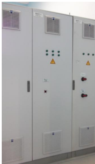
Рис. 10. Щит станции управления
